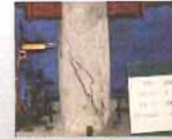
⑥せん断破壊状況 34
