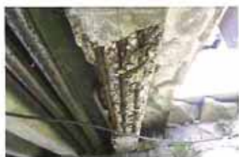
①着工前 劣化状況の確認
