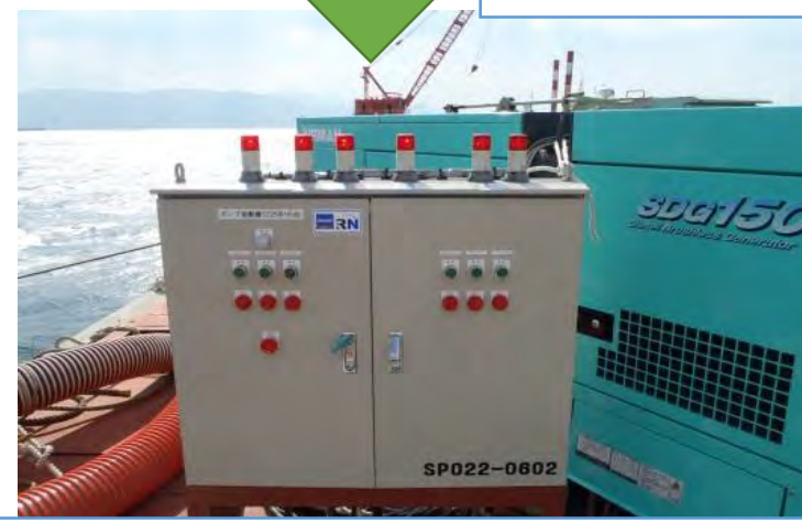
注水自動化システムポンプ起動盤
