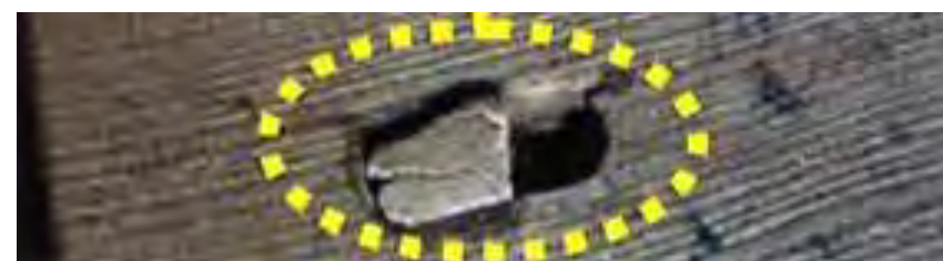
後埋モルタル損傷状況
