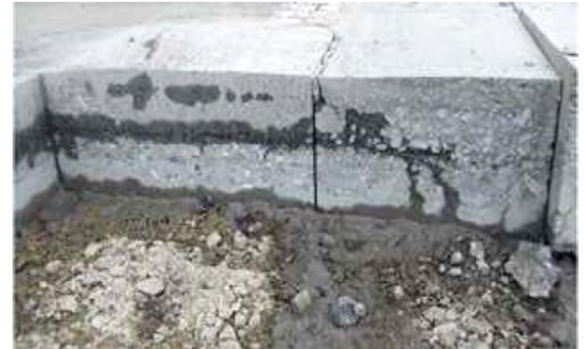
舗装内部の水の滞留による損傷
