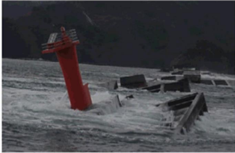
①地震・津波による湾口防波堤の被災
