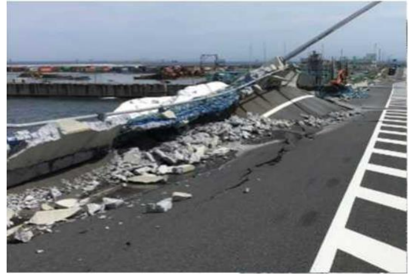
③台風2015号横浜港はま道路船舶衝突
