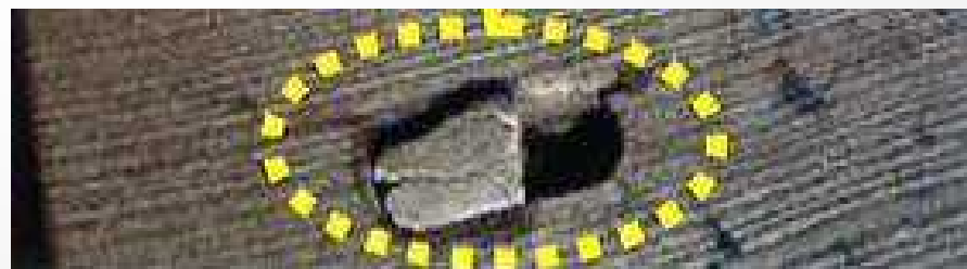
後埋モルタル損傷状況
