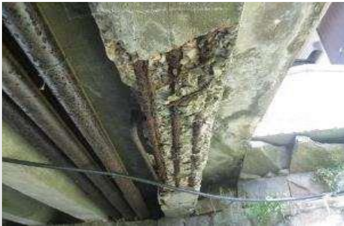
①着工前 劣化状況の確認
