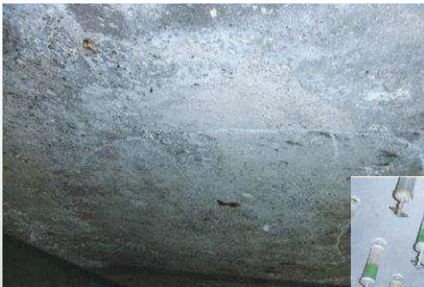
床版劣化状況
