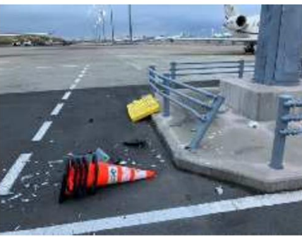
施設損傷写真
