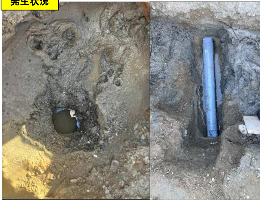
損傷した埋設污水管 φ 150
