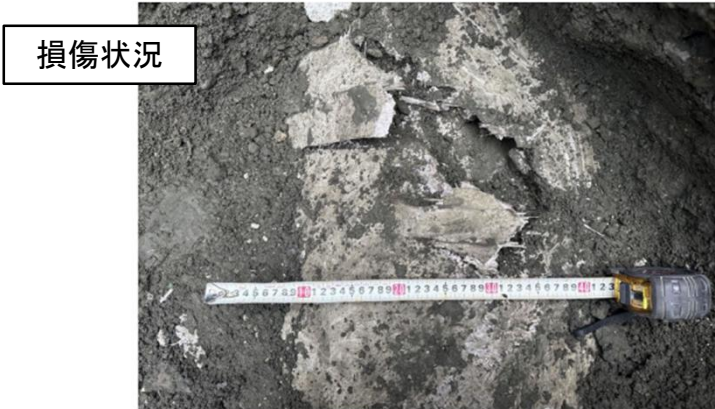
写真 雨水管損傷箇所拡大
