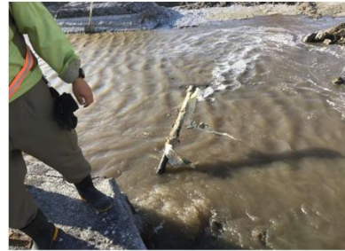
既設水道管損傷（近景）
