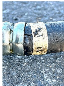
油圧ホース損傷箇所
