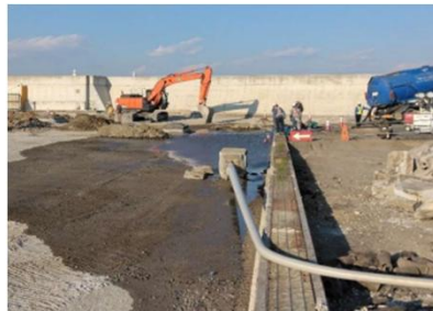
既設水道管損傷（遠景）
