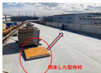
事故発生状況
