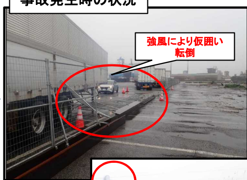
事故発生時の状況
