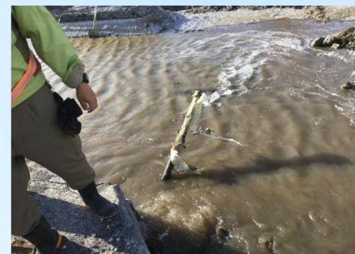
既設水道管損傷（近景）
