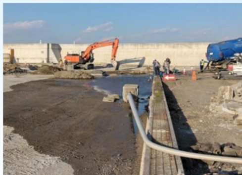
既設水道管損傷（遠景）
