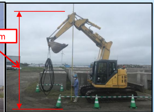
事故発生時の重機の状況(吊り荷走行)
