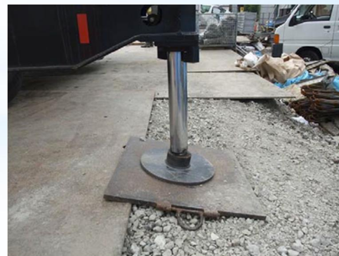
不安定な場所に設置されたアウトリガー
