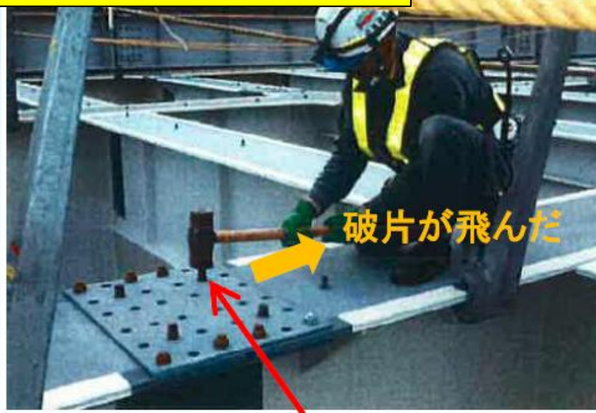
注視ポイント不備による事故の事例
