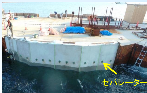
注視ポイント不備による事故の事例
