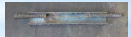
落下した架台部材
