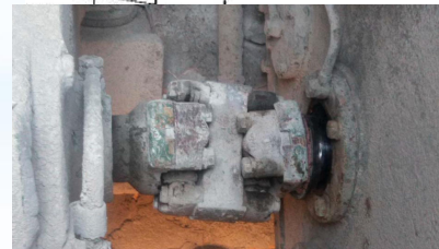
ギアボックスシャフト破断
