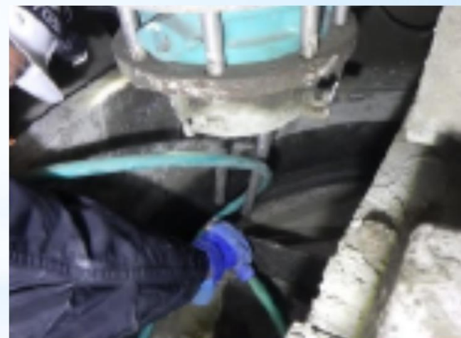
被災状況再現写真(ホースの巻き込み)
