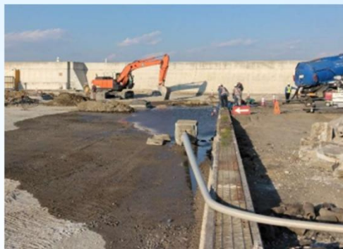
既設水道管損傷（遠景）
