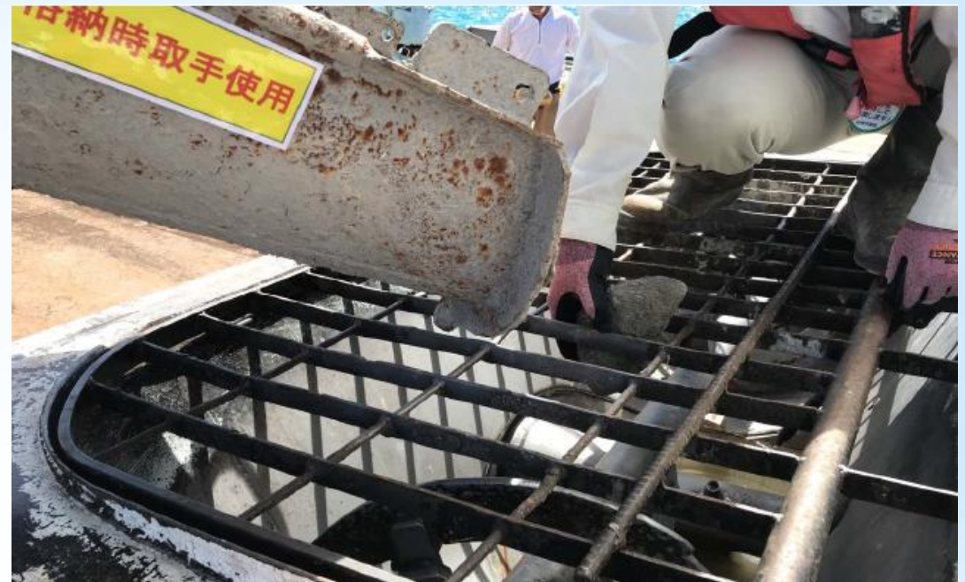
注視ポイント不備による事故の事例
