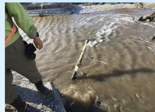
既設水道管損傷（近景）
