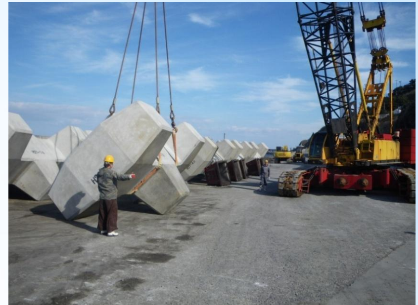
地切りしたブロックの横揺れを止めようとして、仮置き済みのブロックとの間に手を挟む
