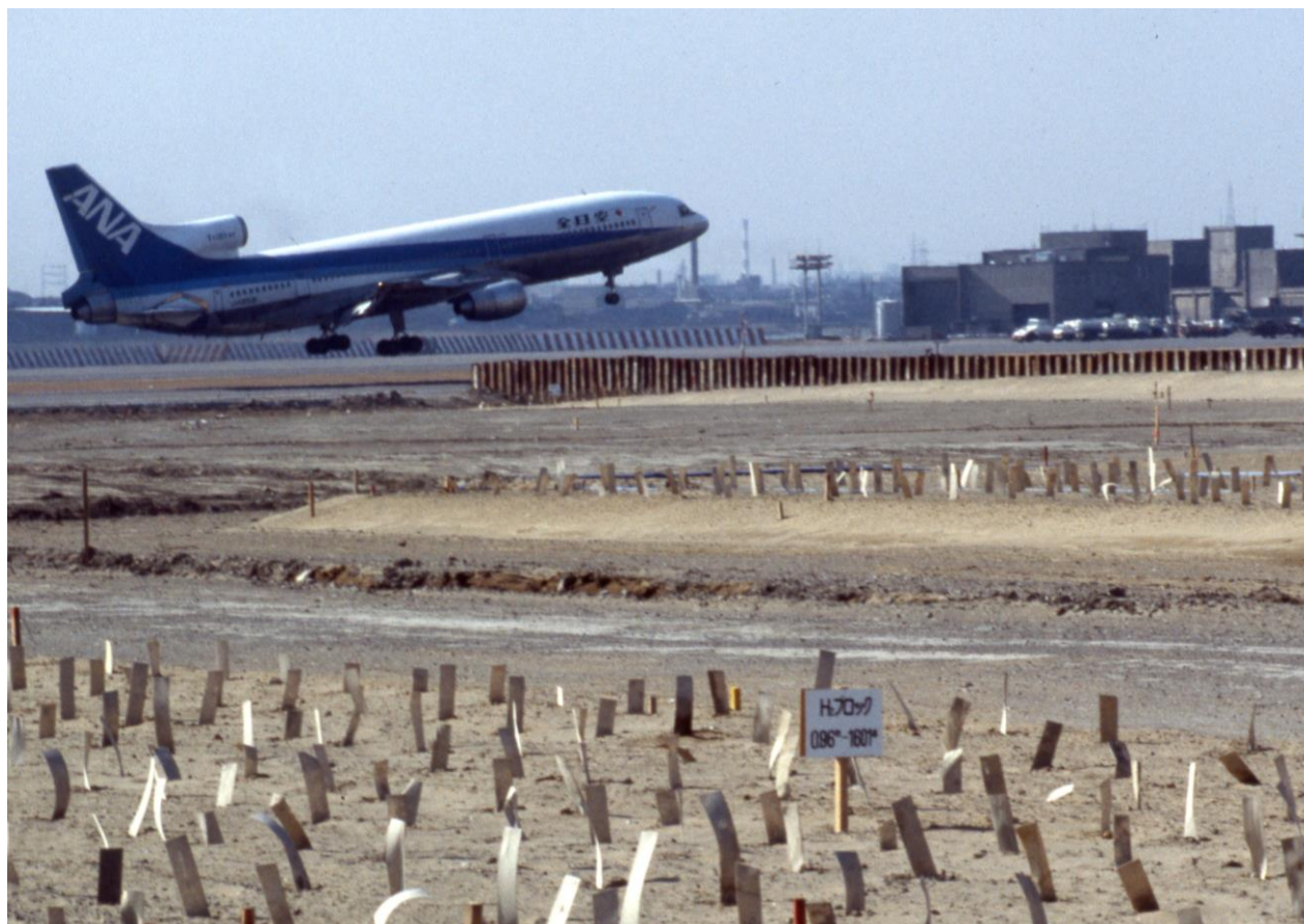
■空域制限下で、急速施工が求められる地盤改良工事 写真提供/ドウ・アーバン
