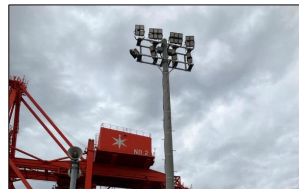
ヤード内照明のLED化
