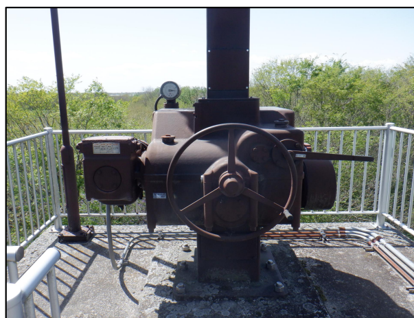
既設開閉装置
