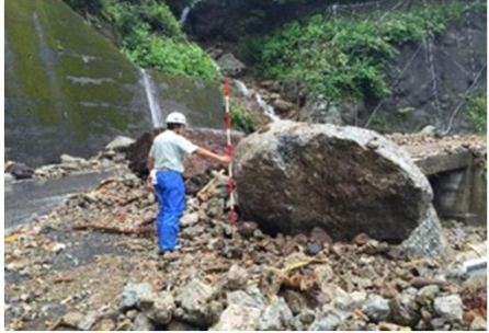
落石状況(平成27年9月)
