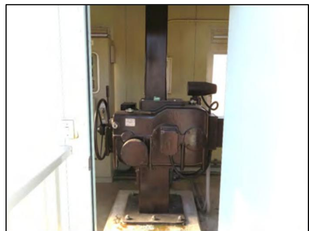
既設開閉装置
