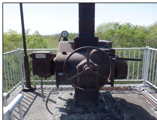
既設開閉装置
