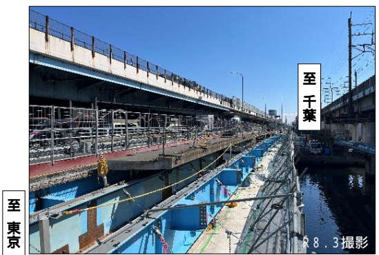
至千葉 至東京 すえひろ 写真 : 末広橋の拡幅工事の施工状況 R8.3撮影
