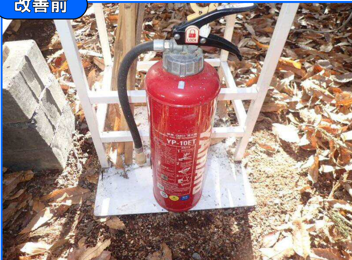
消火器の使用期限切れ
