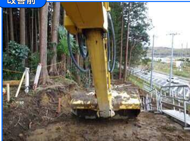
上空架空線への注意喚起の不足
