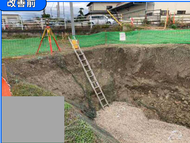
不安定な梯子昇降設備
