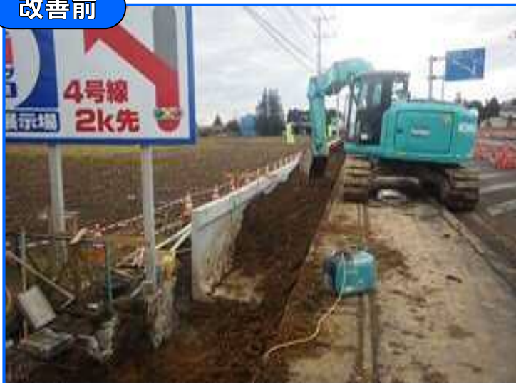
架空線注意の明示旗がオペから見えない
