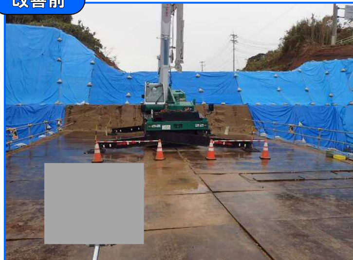
クレーン旋回エリア内への立入禁止明示不足
