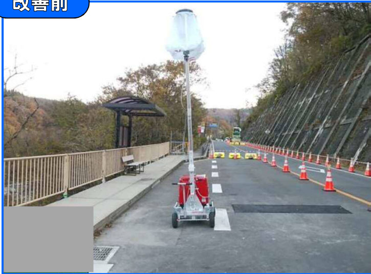
バルーンライト転倒防止の未使用
