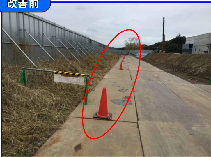
作業員通路との歩車分離 未確保
