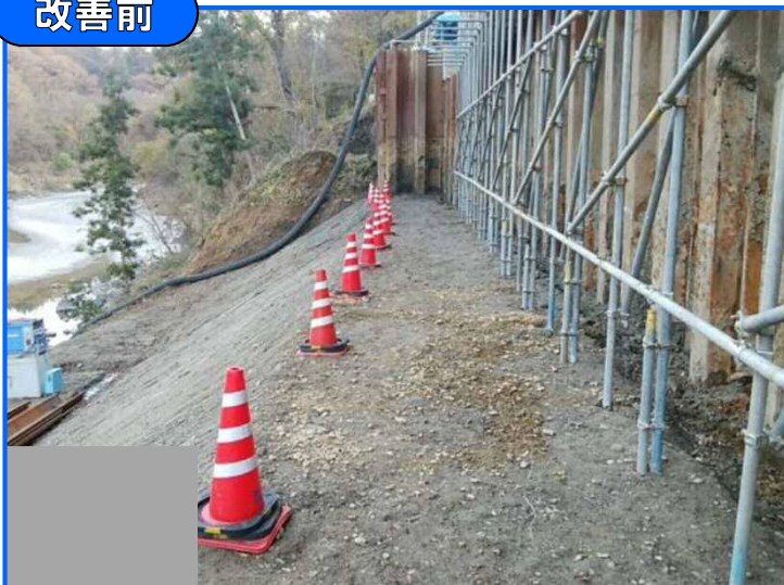
路肩の転落対策が不十分
