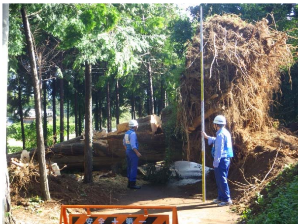
【香取市:市道における倒木除去を実施】
