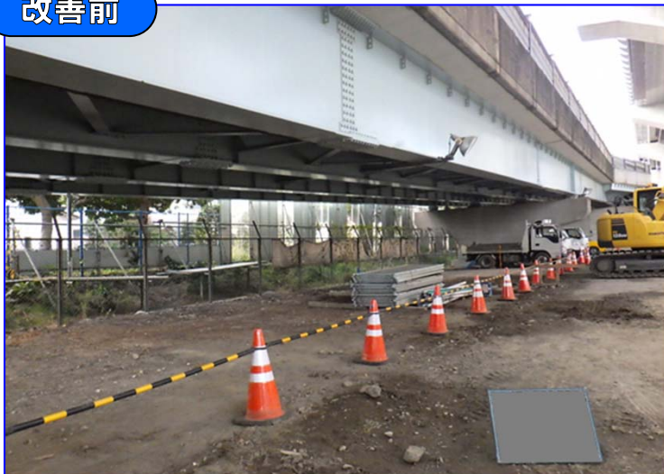
近接構造物（橋桁）に対する注意喚起措置なし
