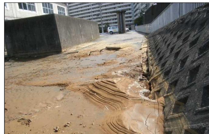
船橋排水機場周辺の液状化発生状況
