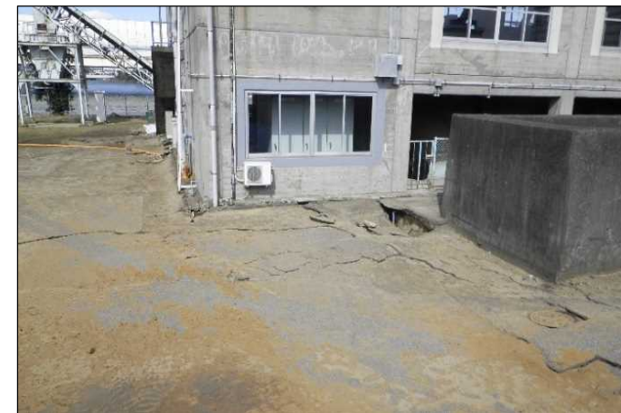
船橋排水機場周辺の液状化発生状況
