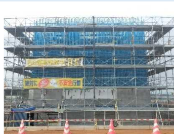
・橋脚コンクリートの骨となる、エポキシ樹脂塗装鉄筋。（青い部分）
