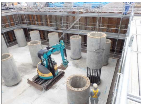
写真③杭上部の引き抜き
