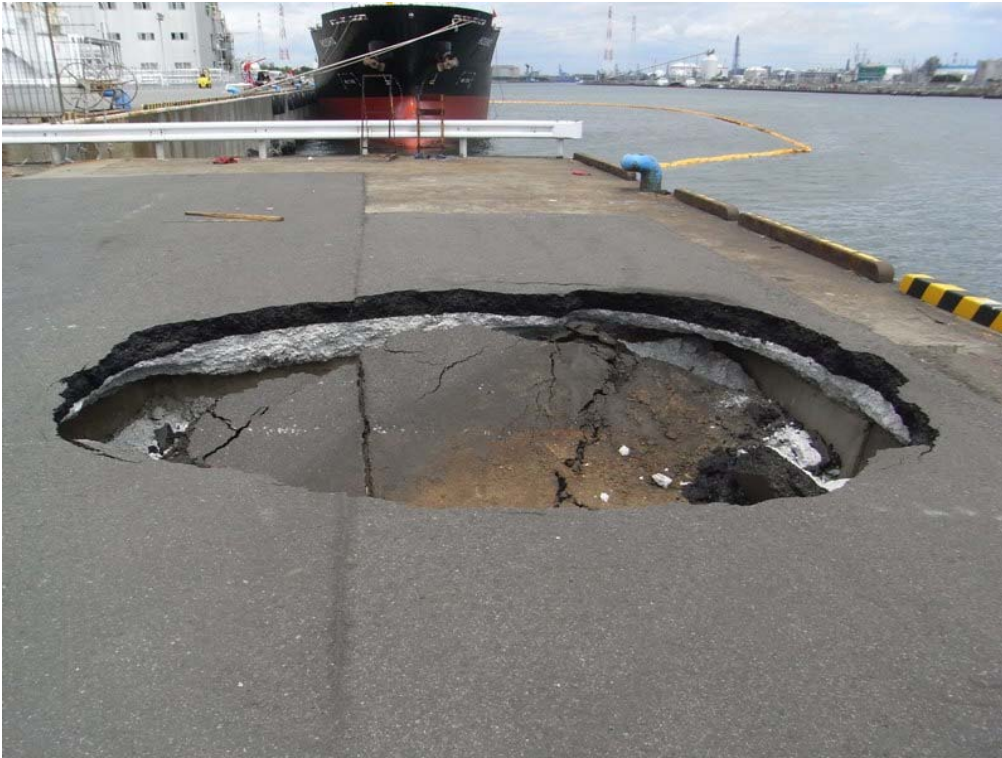
○ 陥没状況（直径約4m）
