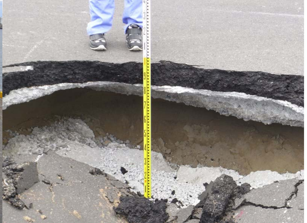
○ 陥没深さ（約1m）
