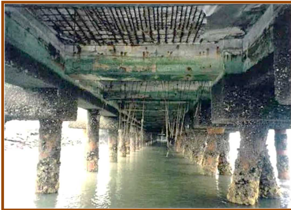
腐食した栈橋
