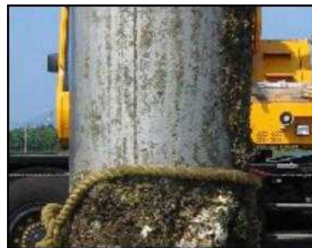
排貝後試験体
