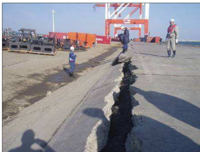
液状化で大きな段差が生じた北ふ頭の岸壁
