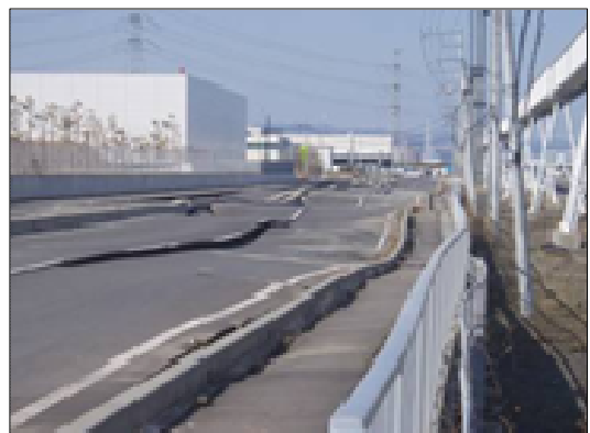
▲液状化で路面が波打った臨港道路5号線
