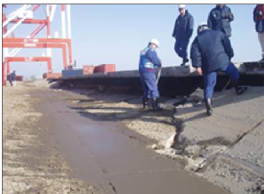
▲液状化で陥没した北ふ頭の岸壁エプロン部
