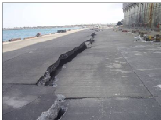
▲ 第1埠頭の岸壁エプロン部に段差が発生
