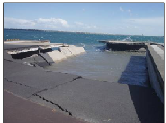
▲ 先端部の護岸が流出した第4埠頭
