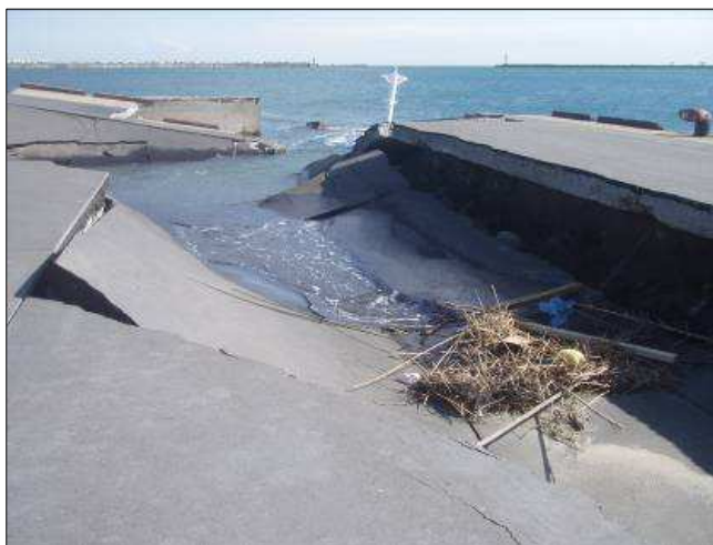
先端部が陥没崩壊した第2ふ頭
