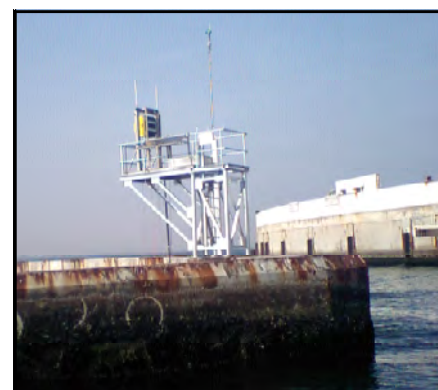
風の塔に設置した観測機器
