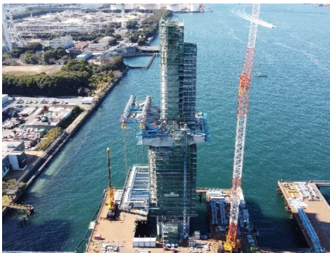
MP2 ピロン柱 コンクリート柱施工 張出架設 移動作業車組立 令和5年2月
